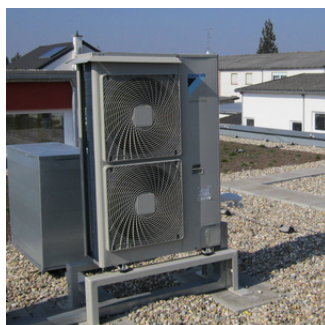
Wärmepumpe Außengerät Quelle: Stadt Rödermark
